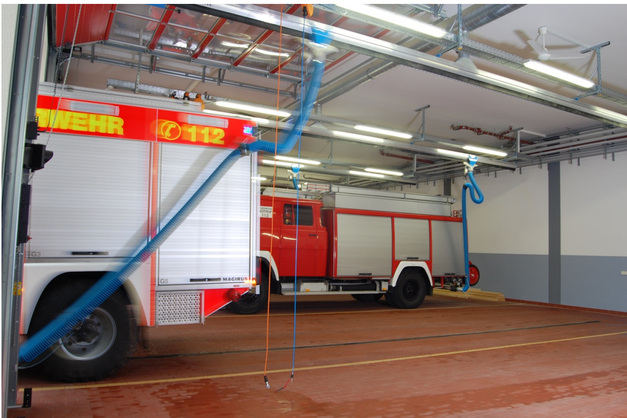
Abkopplung im Torbereich
